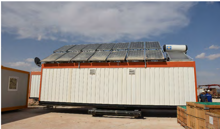
Panneaux solaires déployés
